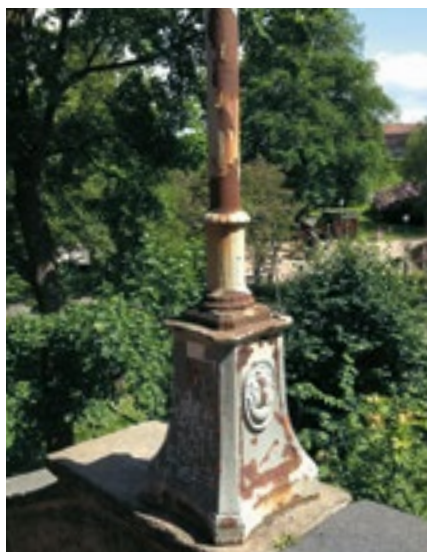
Bild 9. Stolpe som saknar nödvändig underhållsmålning.
