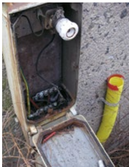
Bild 8. En kopplingslåda fastsatt på hus där marken "satt sig" och dragit med sig kabel och kopplingsplint. Den gula slangen intill är förberedelse för ommontage.
