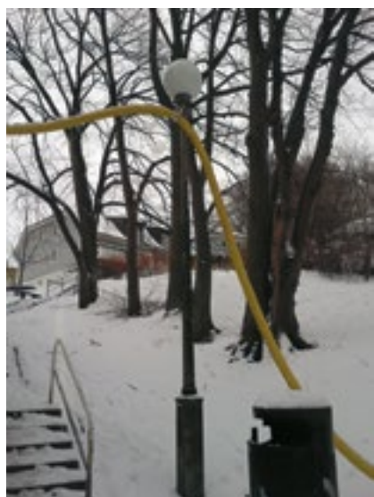
Bild 12. Belysningsstolpe som används för tillfällig upphängning av kablar.
