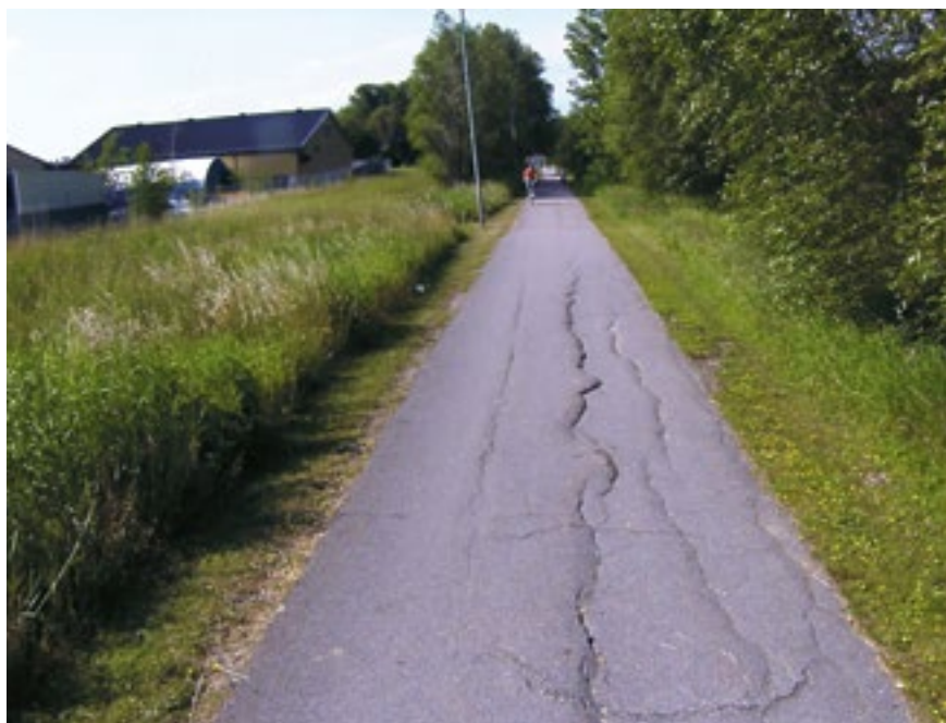
Bild 2. Exempel på cykelväg i akut behov av underhåll.
