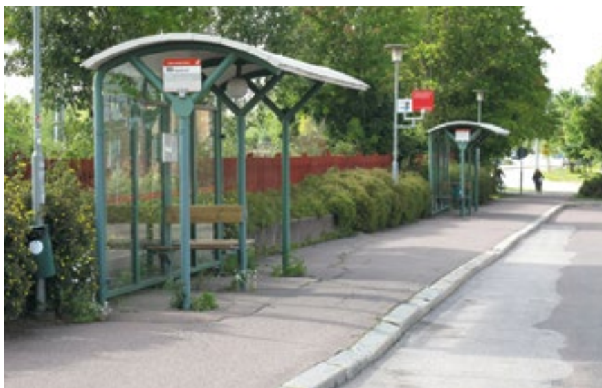
Bild 4. Exempel på sättningar och mindre lyckade lagningar vid en busshållplats (Bild: Samtrafiken).
