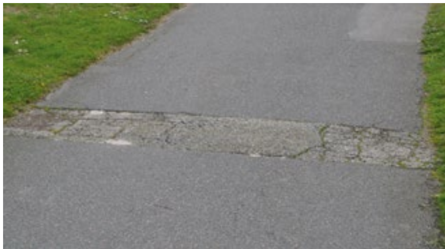
Bild 3. Exempel på misslyckad lagning efter grävningsarbete.
