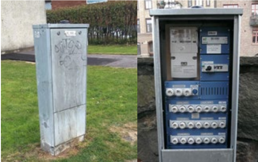
Bild 5. Fristående belysningscentraler med inbyggd styrning som kommunicerar via en antenn.
